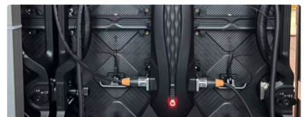
Gesteckte Strom- und Datenleitung
